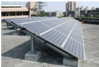
太陽光電組列 (PV Array)
