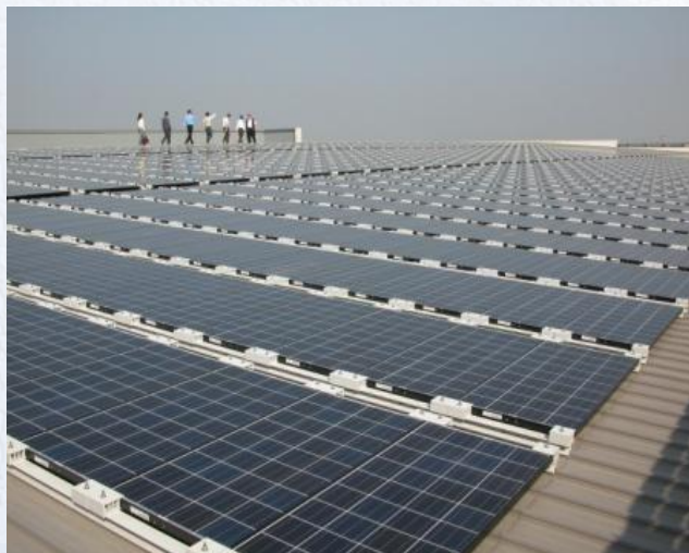
台南市 228.8kWp (多晶矽)
