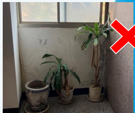
▲ 共同走廊堆置雜物
